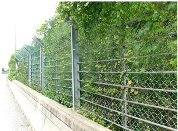
도로부, 낙석방지울타리 전경
