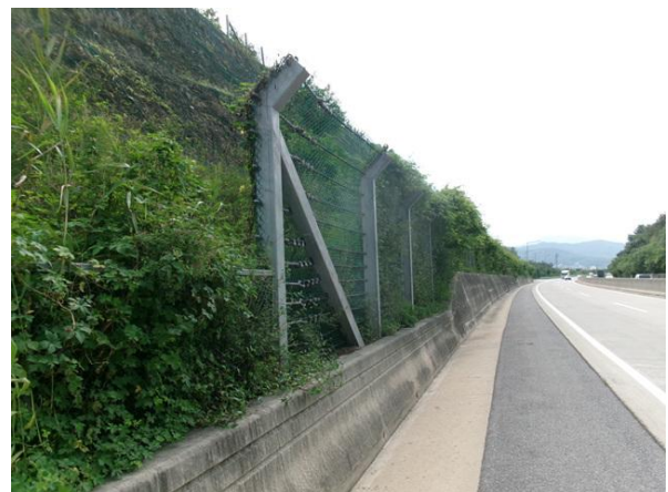
도로부 낙석방지울타리 전경
